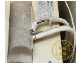
冷氣保溫材破損
