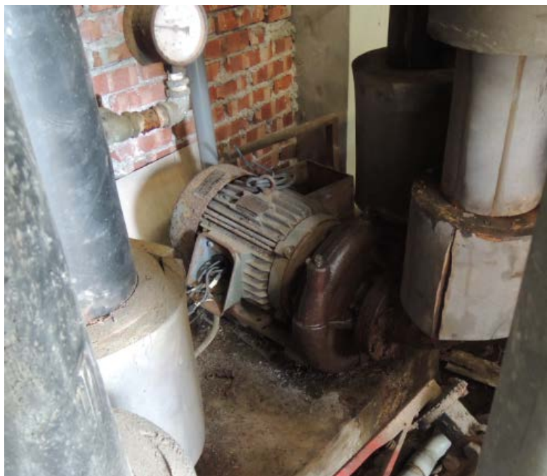
老舊馬達及水泵建議汰換
