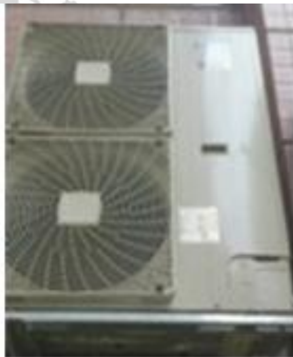
使用氣對水熱泵製造熱水
