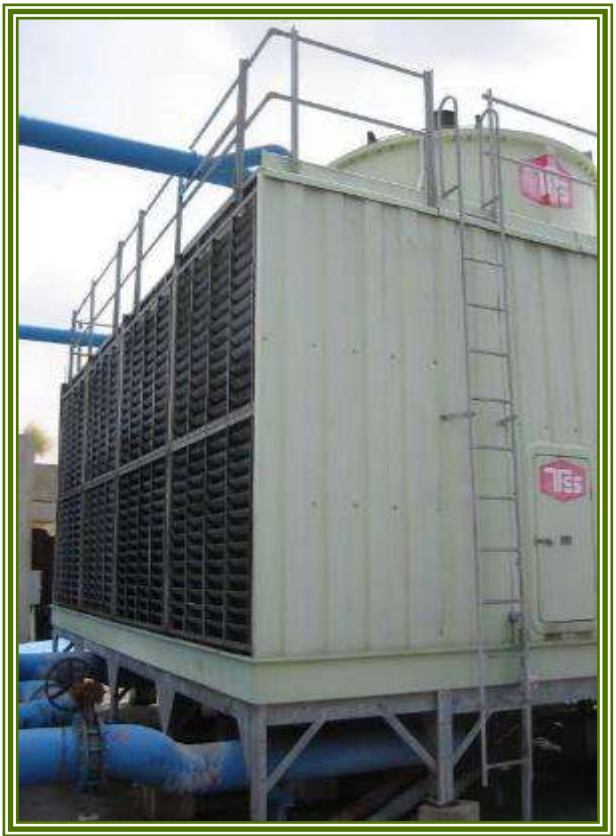
冷卻水塔外觀
