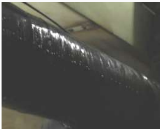
冰水管保溫失效外部結露
