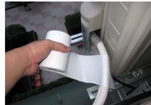
定期檢修冷媒保溫狀態
